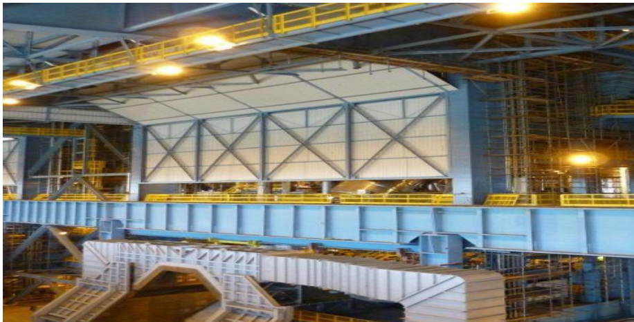
Figura 5. Silos com Sistema de Pesagem
