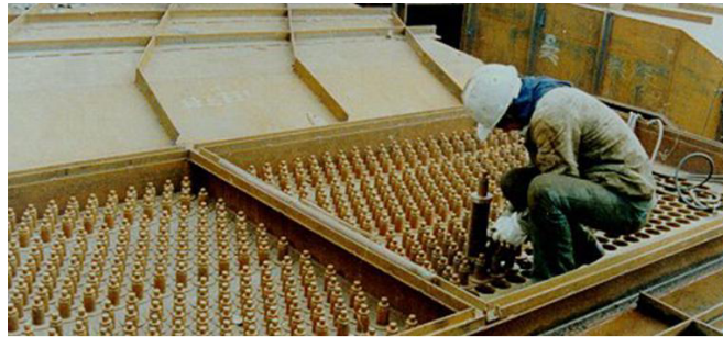
Figura 8. Manutenção do feixe tubular
