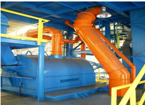
Captação no sistema de recuperação de areia – Peneira
