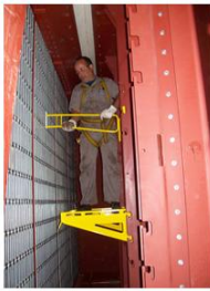
Foto 3.4: Plataforma de manutenção
