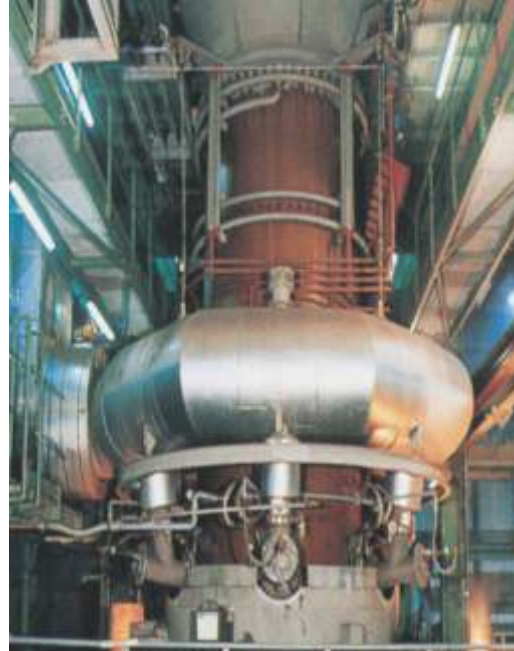
Forno cubilô Zona de fusão
